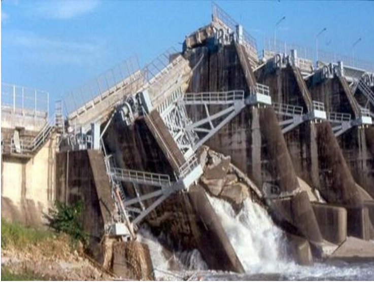
Şekil 13. Hindistan'da deprem etkisiyle çöken bir baraj
