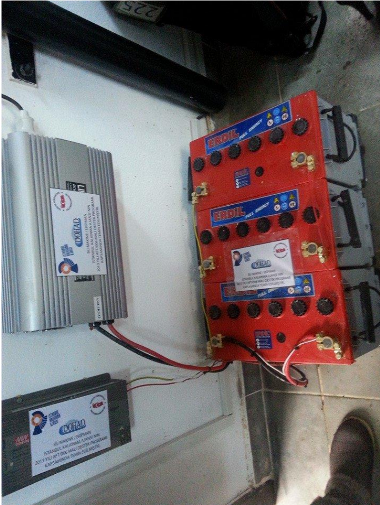
Şekil . Kesintisiz enerji sistemi
